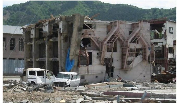
写真 2-2 杭を打っていたが津波の力で10mぐらい浮き上がり、 流されて横転した3階建て(女川で撮影)
